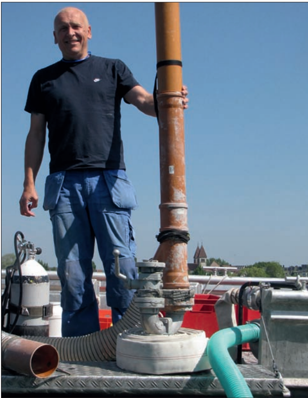
Abb. 6: Die »water dredge«. Im vorliegenden Fall wurde das Saugaggregat mit einer Honda-Druckwasserpumpe und B-Rohrschlauch betrieben. Im Hintergrund die Türme der Kirche von Niederzell. Foto: RPS/LAD, M. Mainberger.
